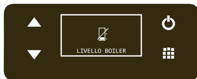
ALARMIERUNG TIME-OUT BEI BOILERFÜLLUNG
